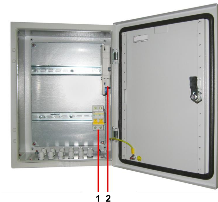
Рис.23 Уличная станция OS-341, внутренние элементы
